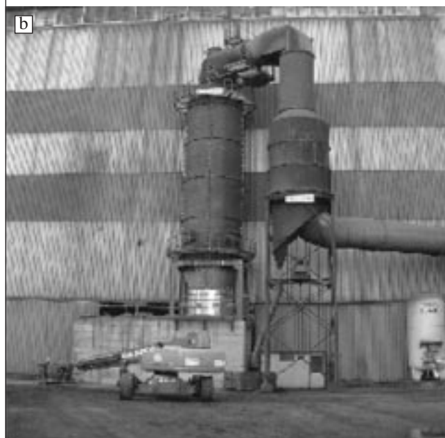
Fig. 14 – Sostituzione di un FDC (a) con una QT (b) in una installazione esistente.
