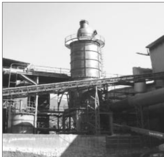
Fig. 12 – Torre di Quenching.
