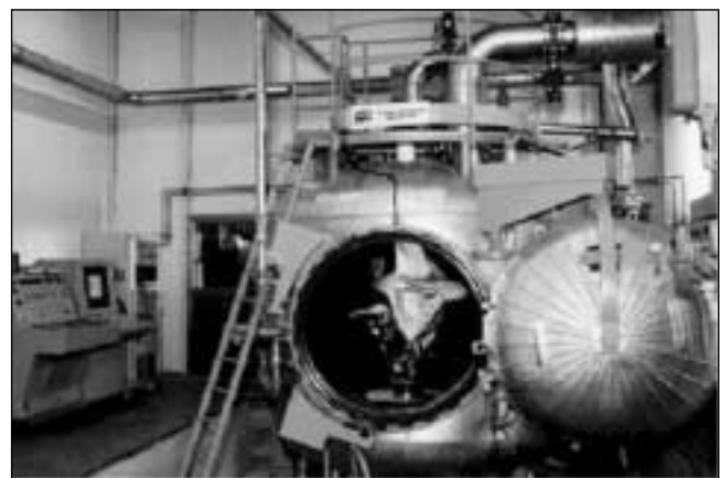
Fig. 1 – Vista d'insieme dell'impianto C.A.P.S.
