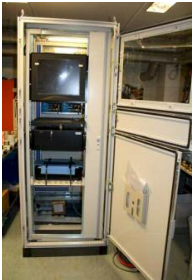
FIG. 1 Integrated monitoring solution. Sistema di monitoraggio integrato.
