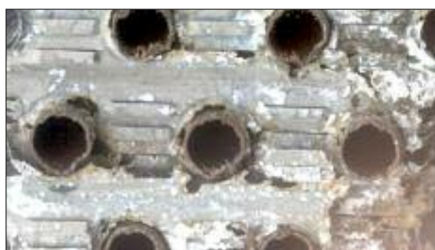
FIG. 1 Corrosione di coil Cu-Al. Cu-Al coil corrosion.
