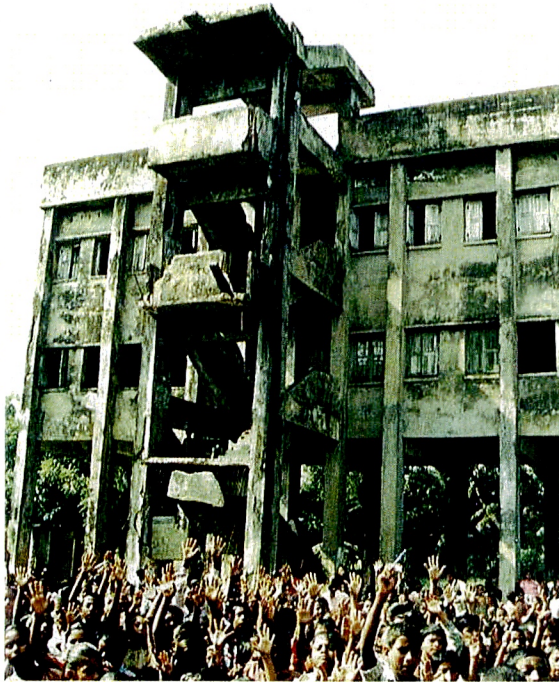
写真-1 腐食した鉄筋コンクリート製サイクロン・シェルター。2部授業の小学校として使われている。
