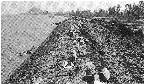
写真一五 石張りの海岸堤防の被災
