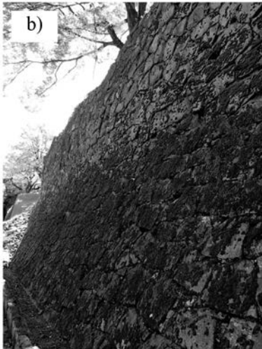
図7 百間石垣の被災状況, a) 崩壊箇所, b) 崩壊を免れた箇所.
