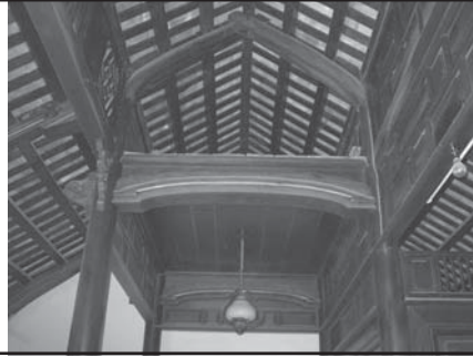
Hình 19. Vài kèo thượng xuyên hạ trên, trên trên là rầm thượng (tra)
