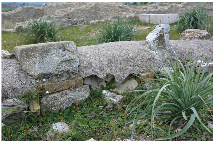
Fig.16 Creste murarie di un edificio dell'abitato. L'esposizione agli agenti atmosferici aggredisce la fattura mediocre delle strutture anche in presenza di blandi sistemi protettivi come una non omogenea chiusura degli spazi tra elementi lapidei (in basso). Le stesse copertine di malta, se non correttamente eseguite o se prive di verifiche cicliche, non sempre sono in grado di impedire lo smembramento del tessuto murario sottostante (in alto)
