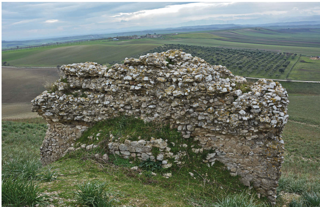
Fig.13 Tratto ovest della cinta muraria. La posizione sul pendio evidenzia il rischio di instabilità accentuato dal continuo dilavamento del terreno
