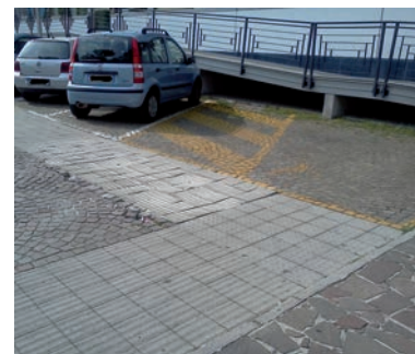
02 | Parcheggio accessibile di una struttura sportiva e residenziale per studenti; le soluzioni tecniche appaiono inefficienti rispetto ai requisiti d'uso richiesti (foto C. Conti).
