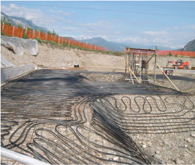
04 | Doppio impianto geotermico (ad aria, per la ventilazione meccanica; ad acqua, per il condizionamento ambientale, realizzato nel lotto EA4 del quartiere di edilizia sociale Casanova a Bolzano, costruito da Lega Coop Bund, 2006-2012. Progetto architettonico Wilfried Moroder e Roberto Palazzi; progettazione termotecnica Energytech, foto di Energytech (Felderer & Klammsteiner).
