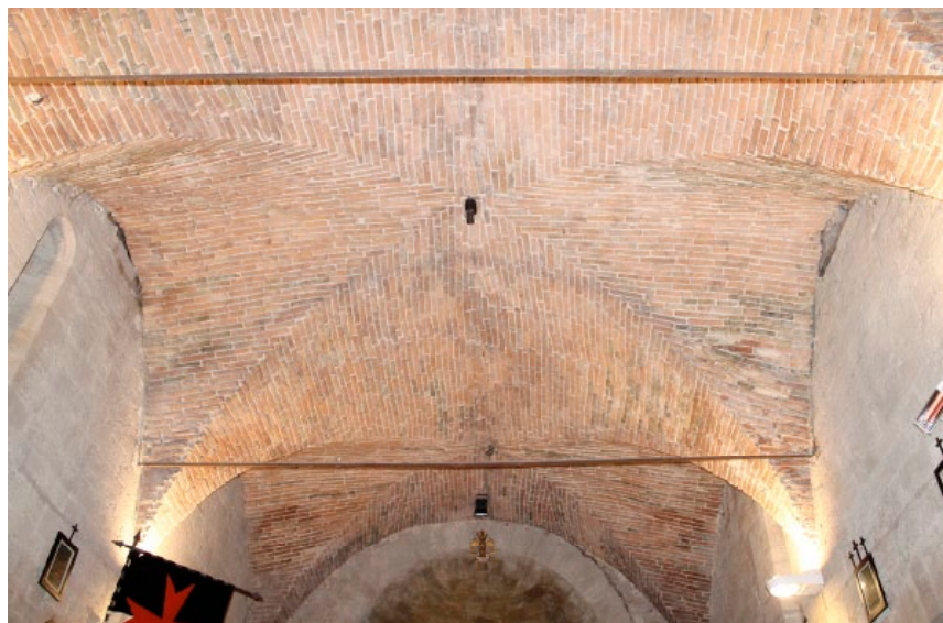
03 | Volta a tre crociere della chiesa, foto di A. Sichi e C. Rosini Three groined vault of the church, photo of A. Sichi and C. Rosini
