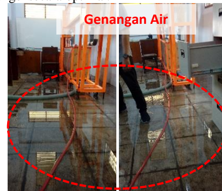
Gambar 1. Genangan Air di Eksisting Lantai Laboratorium Hidrolika.
