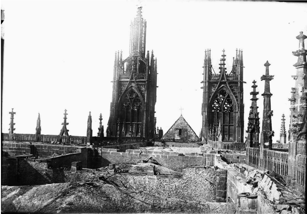
Illustration 4. Vue de la toiture de la cathédrale après l'incendie.
