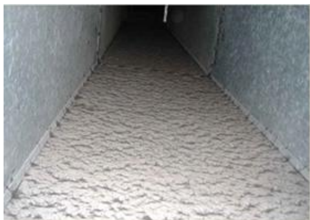
写真 1.1 ダクト内のカビ
