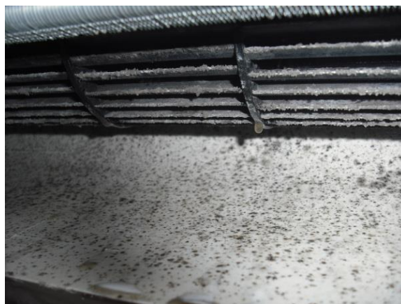
写真 1.2 エアコン吹出口のカビ
