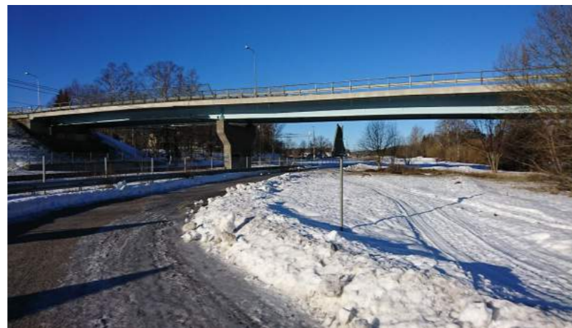
Figur 29. Dannemoravägens bro går över området. Här syns även skoterleden som går genom området på vintern.
