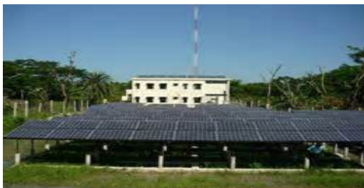
PV array (100kW)
