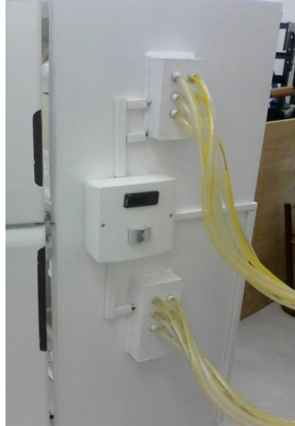
Figura 24 - Cuadro central instalado.
