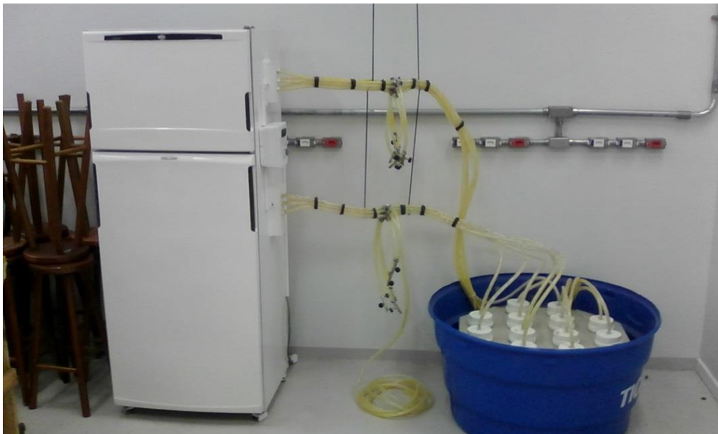
Figura 32 - Biodigestor con deposito de gas terminados.
