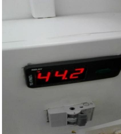
Figura 18 - Controlador de temperatura.
