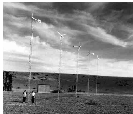
Figura 2 – Equipos eólicos instalados (SPSE/CFI)
