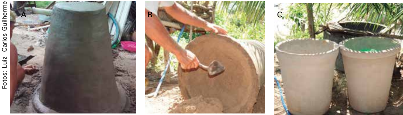
Montagem da forma de areia para a confecção do balde (A). Balde de cimento tombado para retirada da areia utilizada como forma (B). Baldes de cimento prontos (C).
