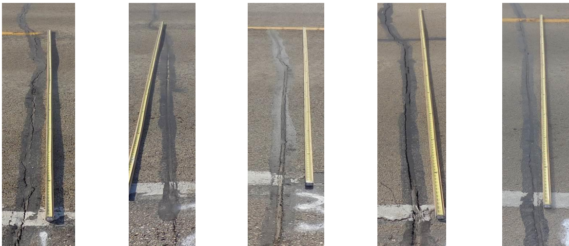
(a) Crack 1.17 (b) Crack 2.5 (c) Crack 3.27 (d) Crack 4.8 (e) Crack 5.13
