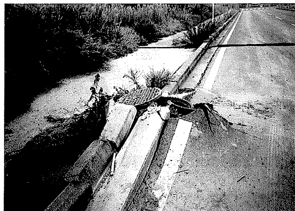
写真1 マンホールの破損
