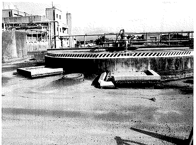
写真-5 周辺地盤の沈下
