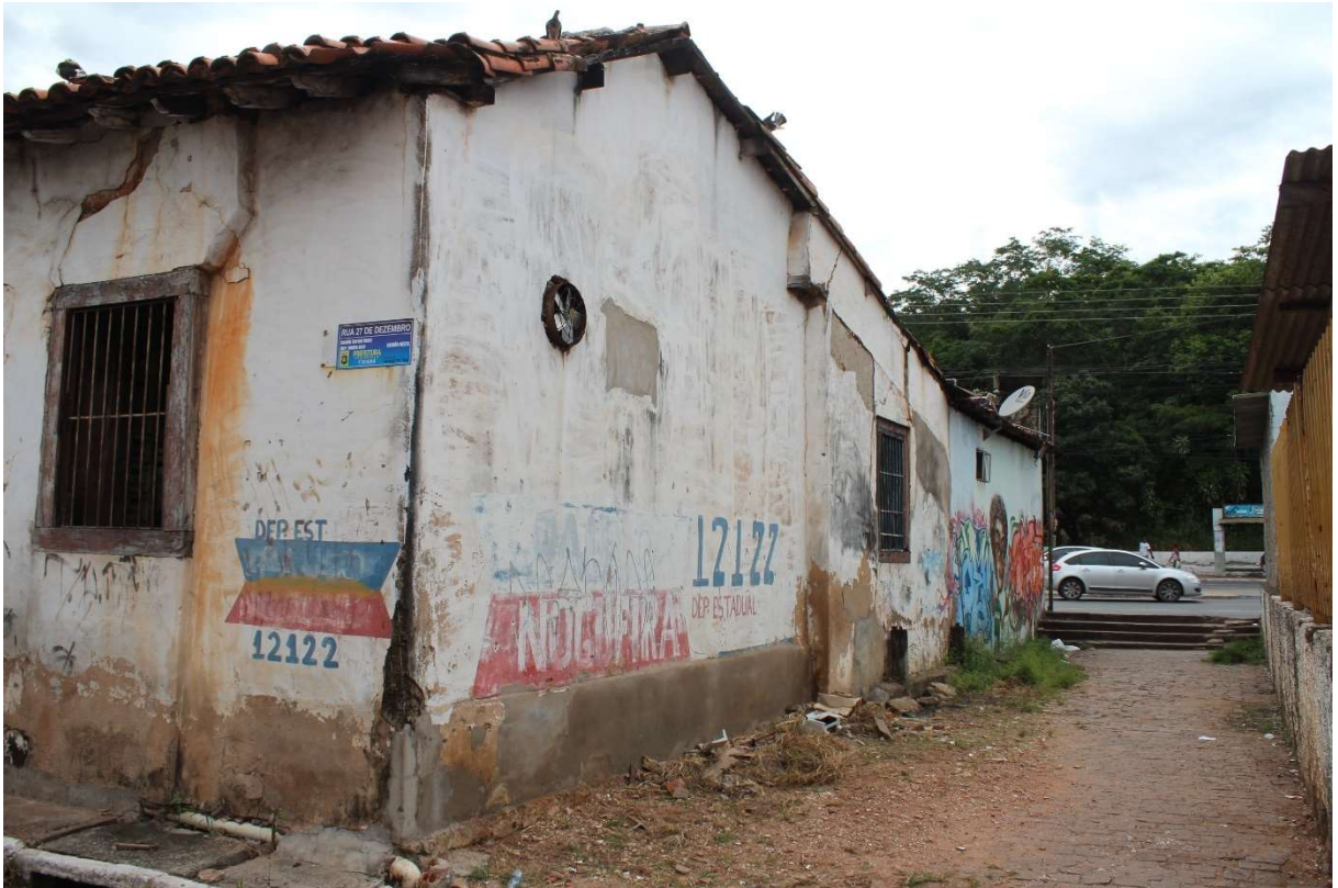
Foto 9- Casa abandonada, localizada no Beco do Candeeiro, Centro, em Cuiabá/MT. - foto Amilton Martins
