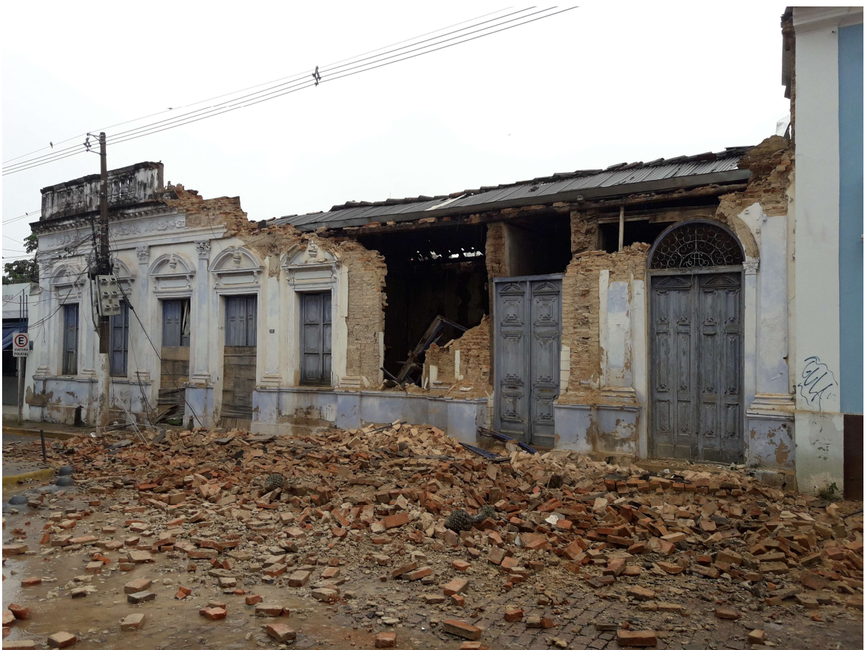
Figura 5-Casarão PEPE após a tragédia, Rua 7 de Setembro, Centro, em Cuiabá/MT. - foto Amilton Martins
