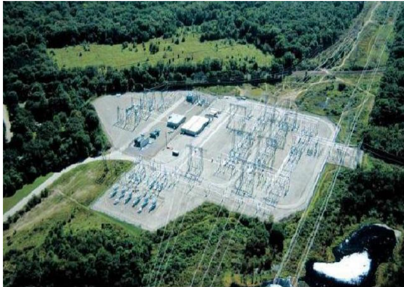
Gambar 2.1. Gardu Induk Transmisi (Sumber: BSE Gardu Induk)
