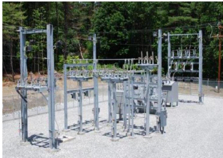
Gambar 2.2. Gardu Distribusi (Sumber: BSE Gardu Induk)
