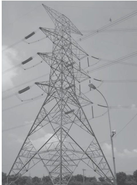
Gambar 10. Isolator yang terpasang pada tension tower type DD
