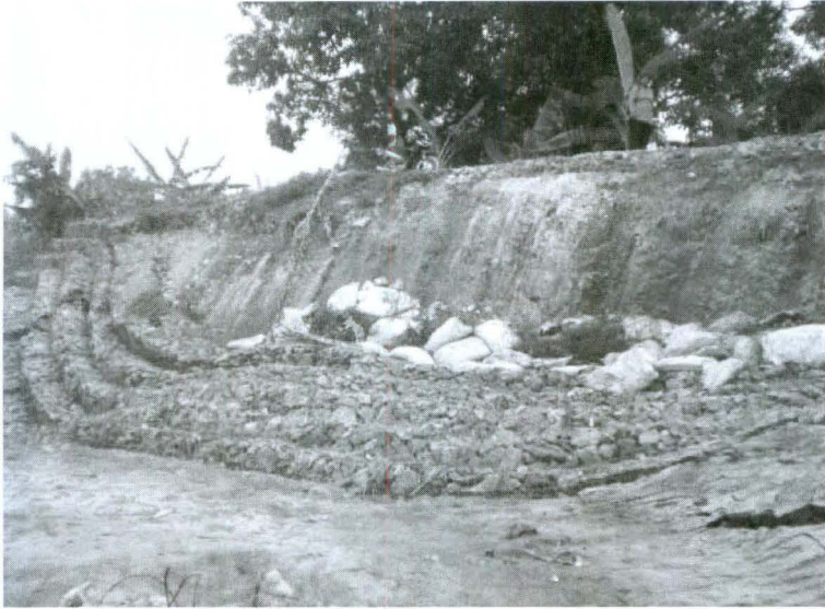
Foto 4.14. Tanggul Ambrol Akibat Banjir di Semambung
