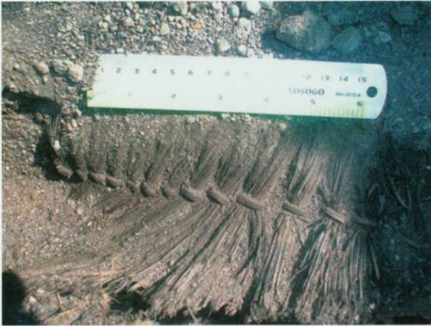
Gambar 3.2 Ikatan atap rumah yang masih utuh.
