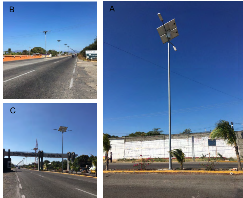
Figura 14. Luminarias con paneles fotovoltaicos colocadas a lo largo de varios kilómetros de la carretera Tehuantepec- Salina Cruz A. Acercamiento, B. vista de conjunto frontal y C. vista de conjunto posterior.
