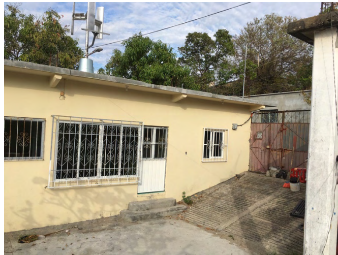
Figura 67. Luminaria instalada en una casa de Tehuantepec, Oax. (vista en perspectiva).
