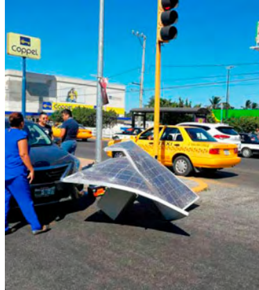
Figura 15. Colapso de una luminaria con panel fotovoltaico debido a los fuertes vientos.
