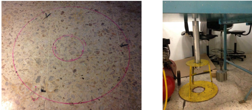
Figura 54. A la izquierda se puede ver el barrenado que se hizo al piso para realizar la fijación, a la derecha se observa la base montada con la reducción de tamaño del poste original.
