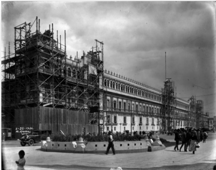
Imagen 11. Obras de restauración en el Palacio Nacional, año 1926, vista parcial y vida cotidiana en esa época en el Zócalo, frente a Palacio Nacional
