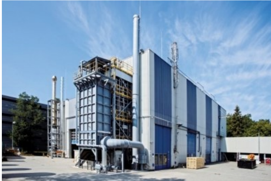
Figure 2.7. Unité pilote de reformage à sec lancé par LINDE en 2016 [43].
