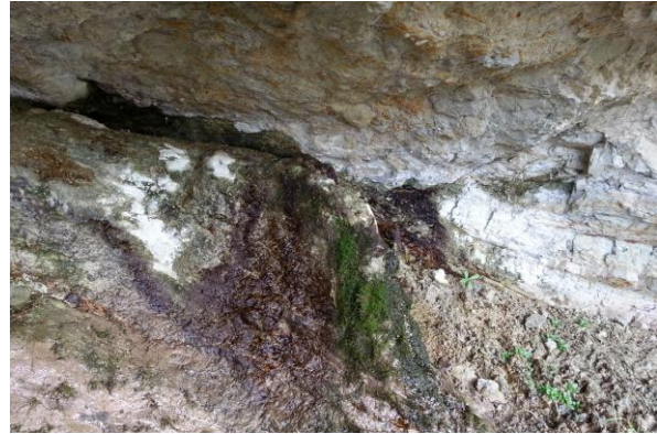
Şekil 8: Çatlaklar arasından sızan zemin suyu.
