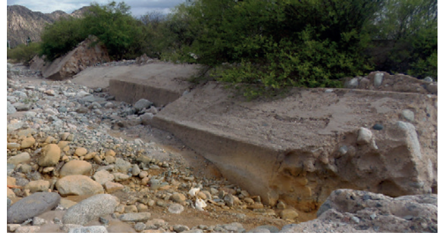
Figura 4 (superior). Detalle del muro actual volcado y destruido por la actividad erosiva
