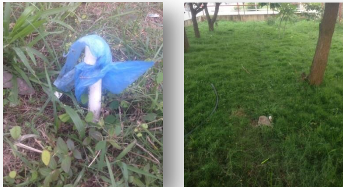
Fotografía 9. Puntos de riego en mal estado e inhabilitados para su función
