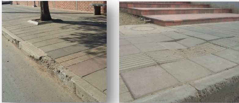
Fotografía 8. Hundimientos // Mal estado en sardineles y andenes por uso indebido
