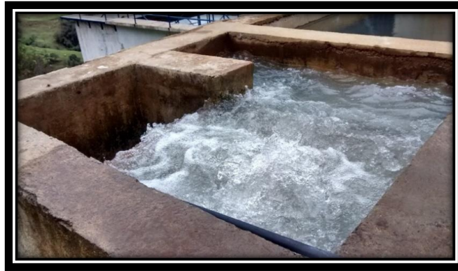
Figura 11. Entrada de Agua a la PTAP
