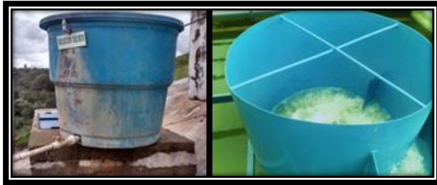
Figura 13. Tanque de Solución de Alumbre y cámara de mezcla rápida
