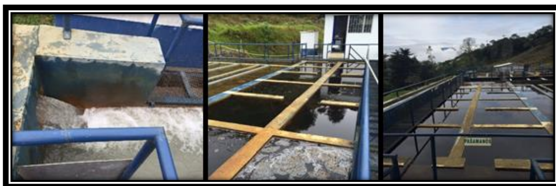
Figura 26. Floculador hidráulico tipo Cox
