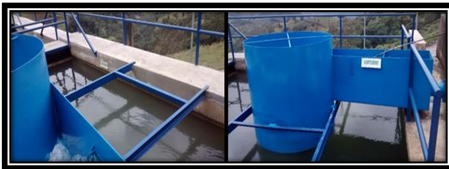
Figura 14. Tanque de floculación y cámara de mezcla rápida
