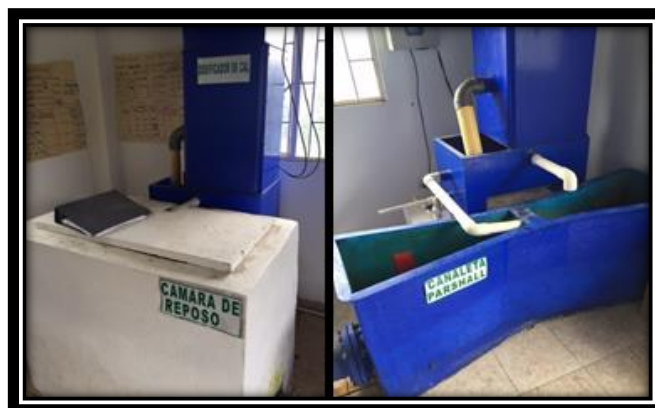
Figura 24. Cámara de Reposo y Canaleta Parshall
