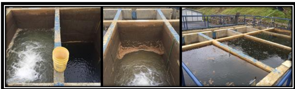
Figura 28. Tanques de Filtración
