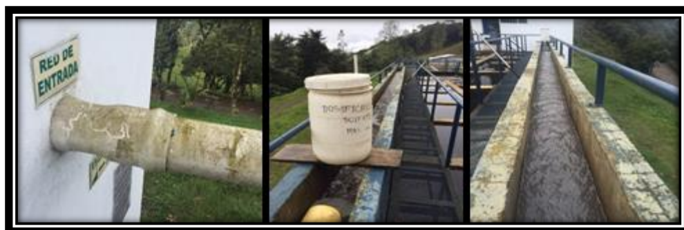
Figura 25. Tanque dosificador de alumbre auxiliar
