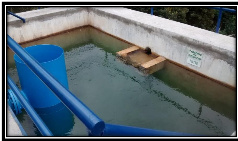
Figura 16. Tanque de Filtración
