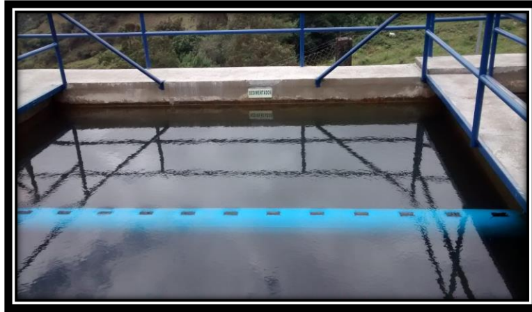
Figura 15. Tanque de Sedimentación
