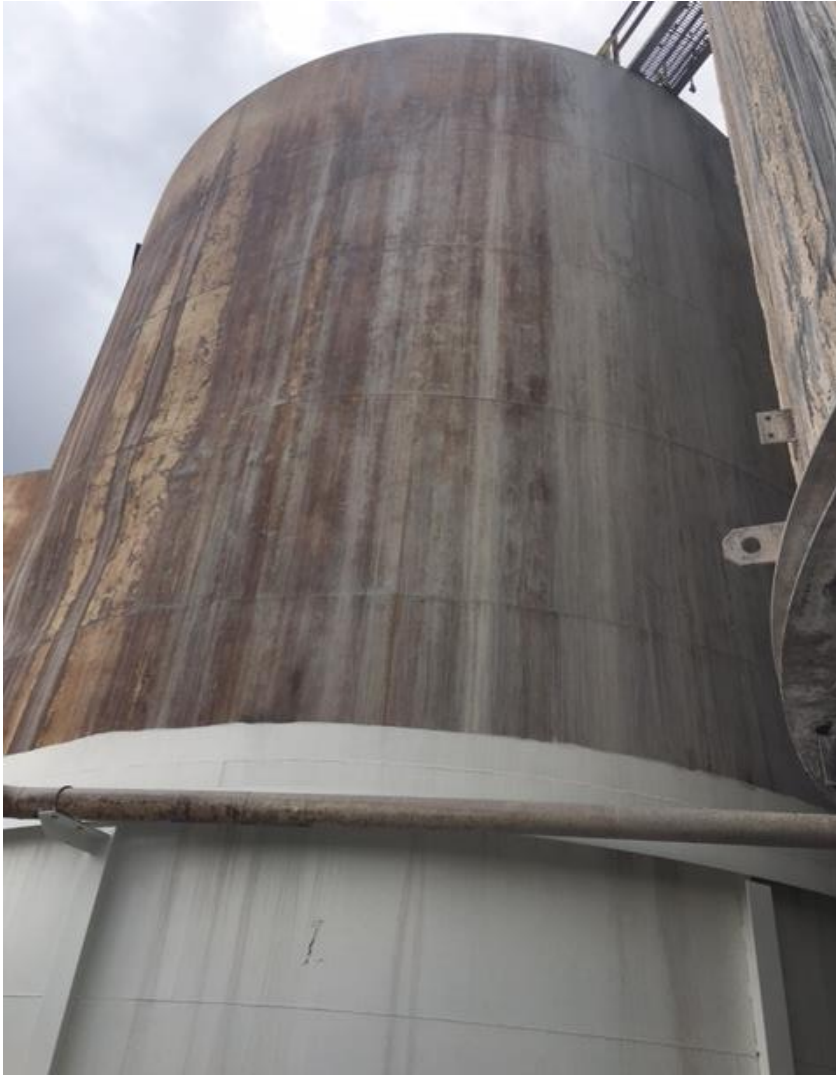
Tanque T-54 antes de la intervención
