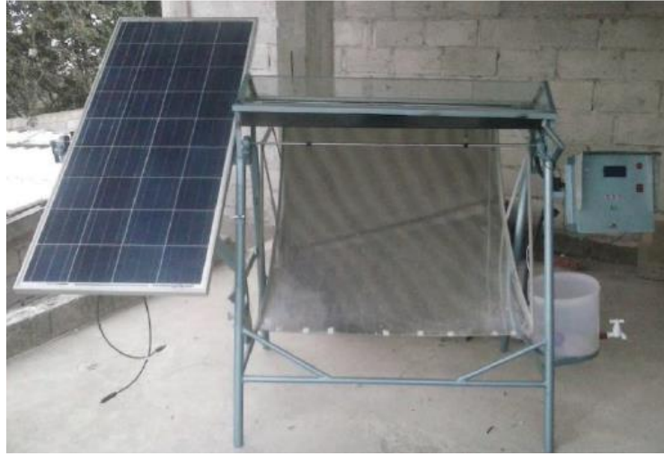
Figura 19. Sistema automático de purificación.
