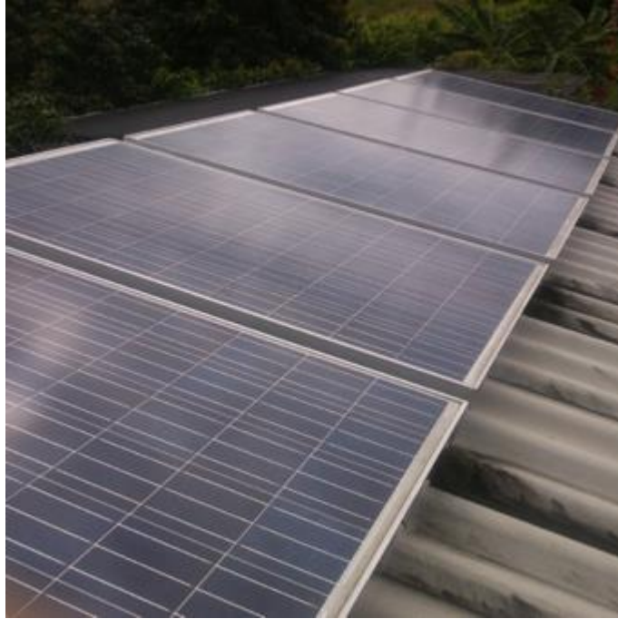
Figura 38. Paneles solares instalados.
