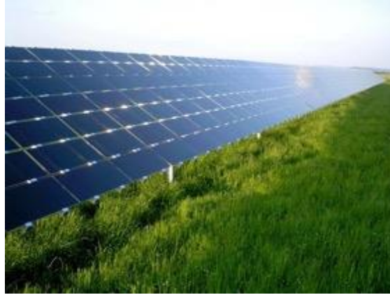
Figura 20. Paneles solares fotovoltaicos de capa fina.
