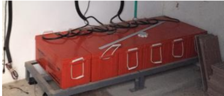
Figura 25. Instalación Baterías conectadas
