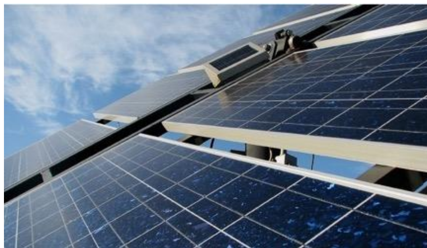
Figura 9. Panel solar fotovoltaico
