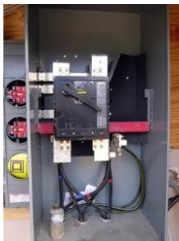
Figura 13. Interruptor de transferencia eléctrica
