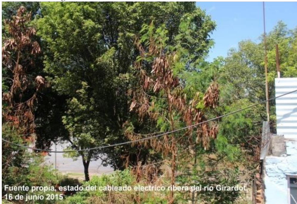
Fotografía 7. Estado cableado eléctrico ribera del río Girardot.
