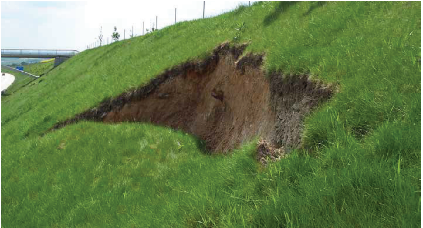
Abb. 1: Böschungsrutschung an der BAB A17
