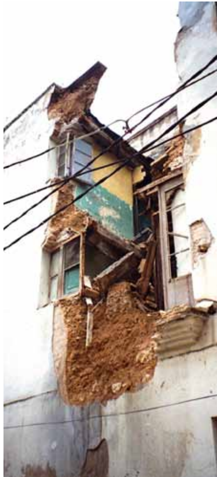
IMATGE D'EDIFICI ON LA FAÇANA VA COL·LAPSAR PARCIALMENT A CAUSA DE LESIÓ DE LIQÜEFACCIÓ
