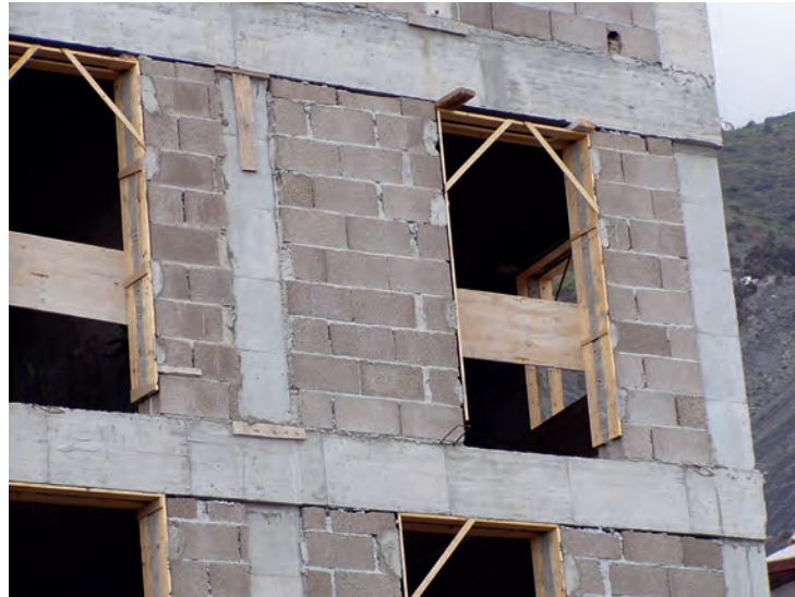
Fig. 3: construcción de fachada de vivienda realizada con bloques (ejemplo de carencia de emparchados de la estructura, deficientes juntas verticales, etc.).
