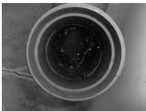
Figura 12: Bajante saturada por una incorrecta conexión de los colectores que unen varios sumideros del canalón en una única bajante.
