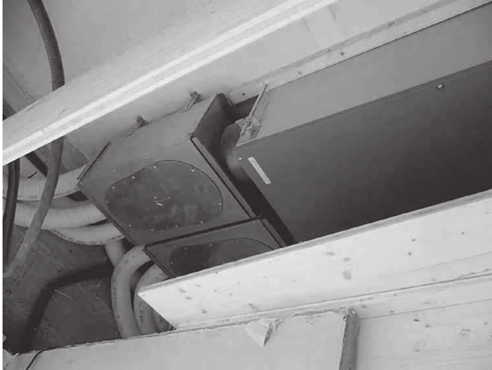
Figura 11. Detalle máquina de ventilación mecánica. Confor Air 200. Zehnder Group (rendimiento real 89,4%). Autor: Marc Folch
