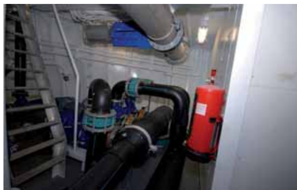
Figur 7. Sjøvannspumper med ND 250 samlestokk.
