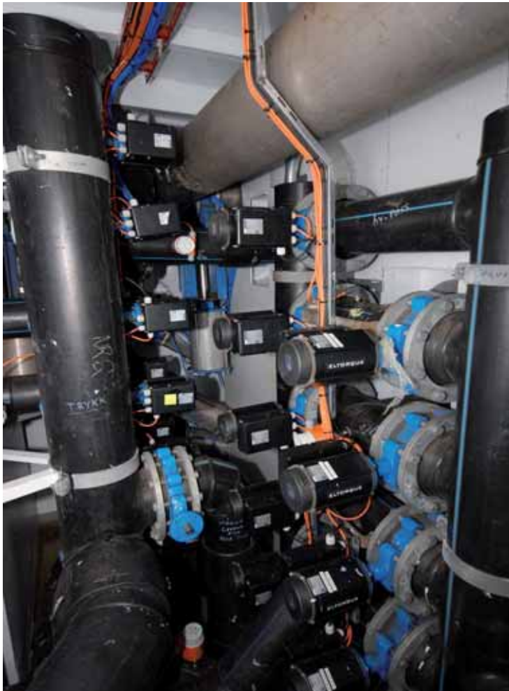
Figur 10. Bilde fra en del av pumperommet. De orange og grå boksene montert på tilførselsrørene til rommene er flowmetre. De svarte horisontalliggende boksene i forgrunnen er aktuatorer som stenger og åpner vanntilførsel til føringsrommene (via fjernstyring fra touchpaneler).
