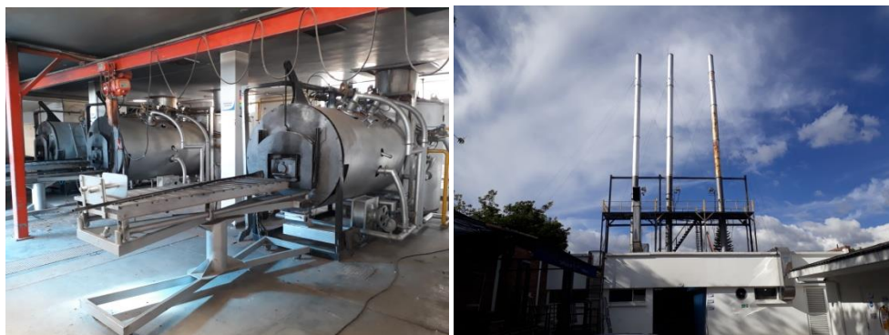
Imagen 3. Chimeneas y Hornos Crematorios Cementerio Norte
