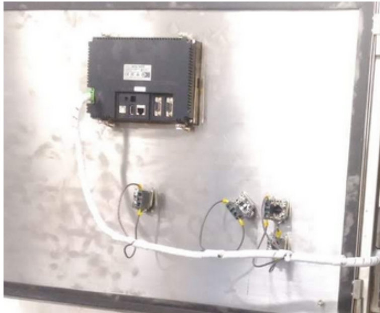
(a) Puerto Ethernet en HMI
