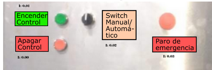
Figura 44: Pulsadores e interruptores del tablero de control
