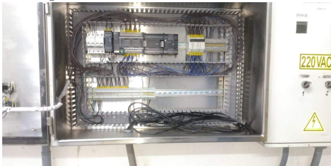
Figura 9: Instrumentación instalada en el tablero de control
