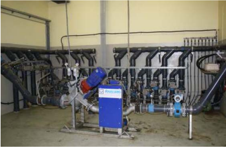
Abbildung 8: Pumpenstation auf dem Untersuchungsbetrieb A
