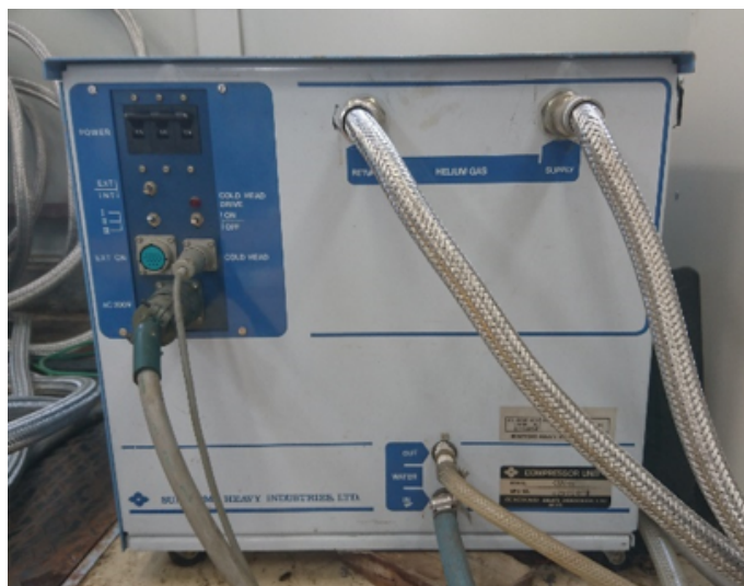
図 2.17: コンプレッサー外観
