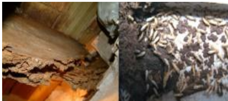
Figura 25. Madera atacada por colonias de termitas [2]
