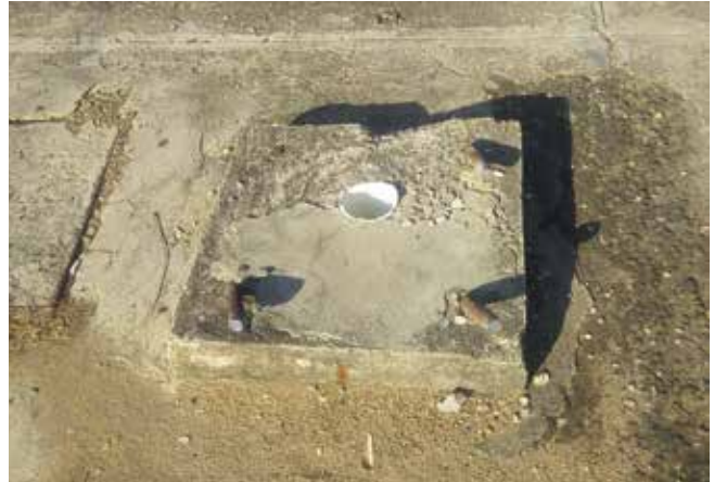
Tornillos sobresaliendo donde antes había un sistema de comunicación.
