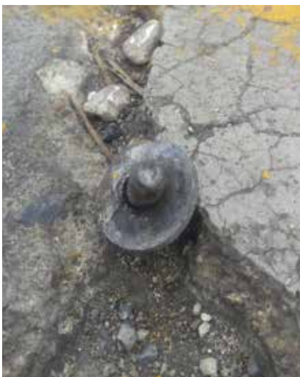
Tornillo que sobresale
