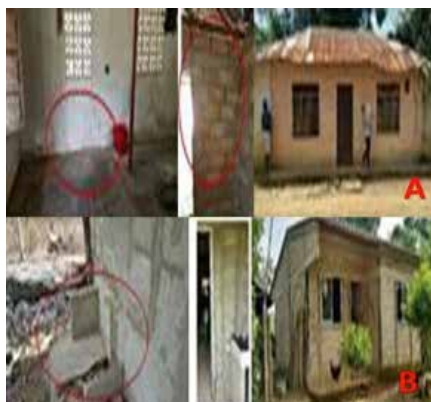
Figura 2. Patologías en viviendas. A) Patologías en VA. B) Patologías en viviendas de interés social en VA. Fuente: Autores
